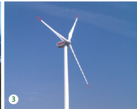
3 白俄罗斯GRODNOENERGO风电场 Belarus GRODNOENERGO Wind Farm
